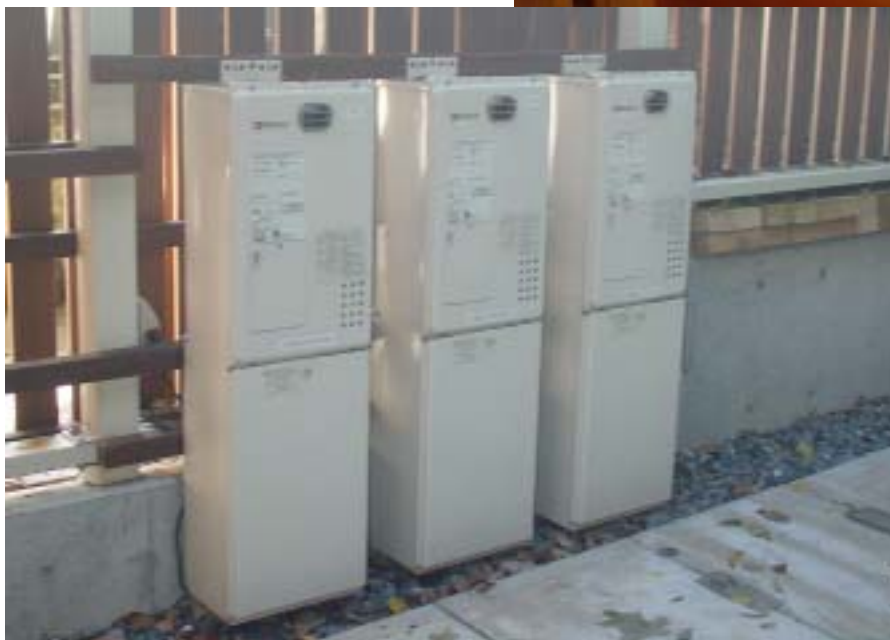
床暖房熱源機 温水暖房専用ガス熱源機 3台設置
