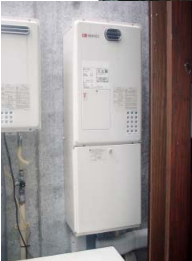
床暖房熱源機
